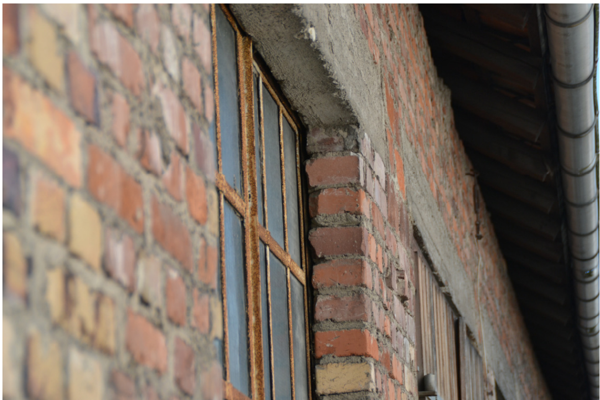
Abb. 2: Spalten im Bereich der Fensterrahmen. Diese gehen nicht sehr tief, sind aber als Zwischenquartiere möglicherweise geeignet.
