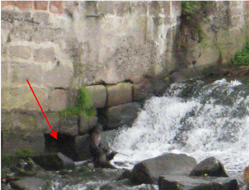
Bild 14: Beschädigtes Mauerwerk am Wehrfuß des rechten Lahnufers
