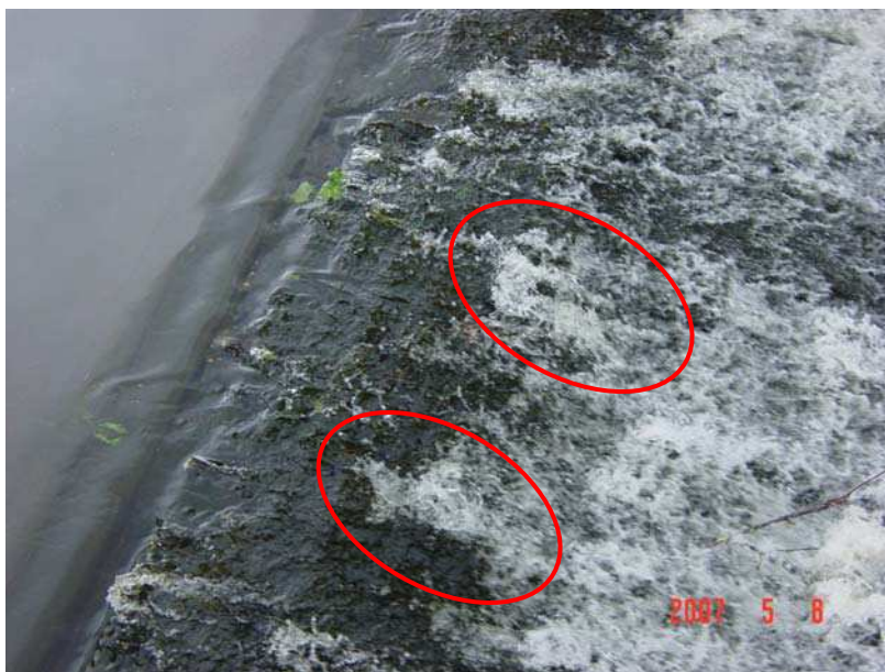
Bild 3: Ungleichmäßige Wasserablösungen auf der Wehrkrone
