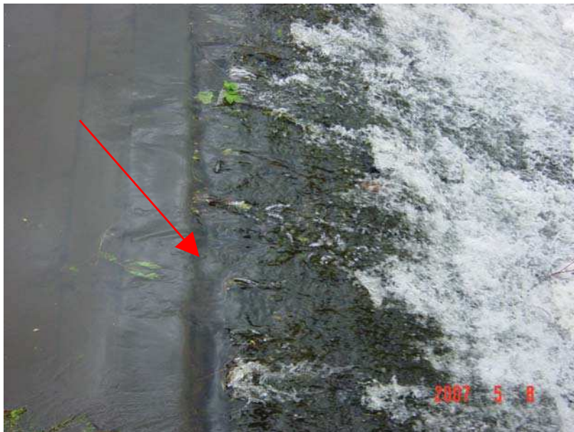
Bild 2: Deutliche Auswaschungen der Deckwerksfugen auf der Wehrkrone
