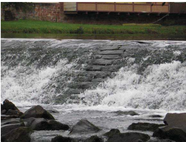
Bild 5: Hochpunkt in der Wehrkrone führt zu Strömungsabriss
