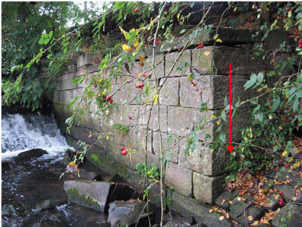
Abbildung 20: Setzungen im Eckbereich der Stützmauer im Unterwasser am linken Lahnufer
