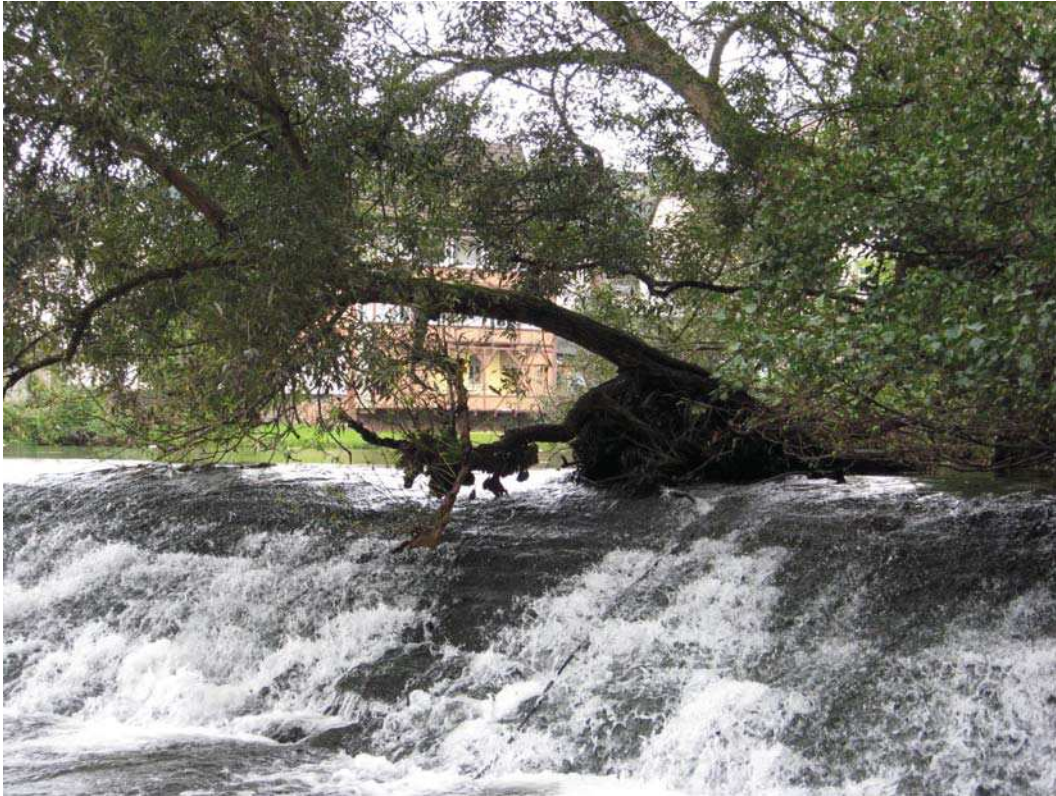
Abbildung 15: Umgestürzter Baum im linksseitigen Bereich der Wehrkrone
