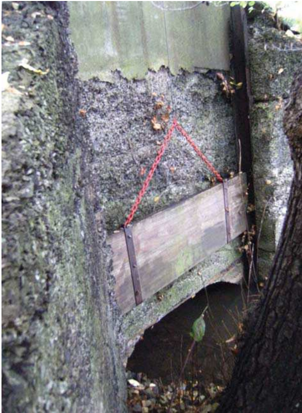
Bild 12: Schützanlage am Einlaufbauwerk Hirsemühle
