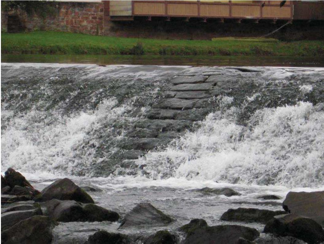
Abbildung 17: Hochpunkt in der Wehrkrone führt zu Strömungsabriss
