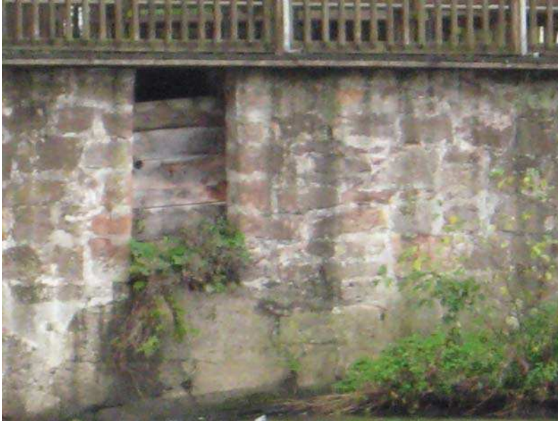
Bild 16: Bewuchs in der Stützmauer rechts im Oberwasser
