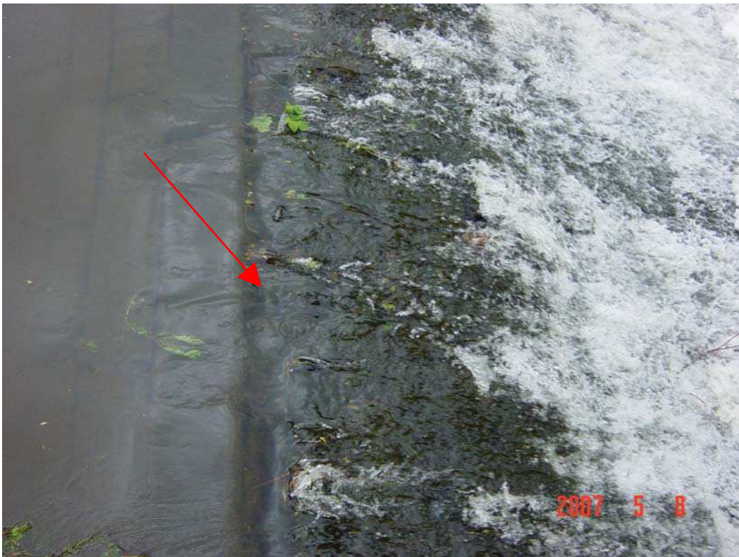
Abbildung 6: Deutliche Auswaschungen der Deckwerksfugen auf der Wehrkrone
